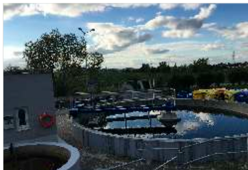
Dosazovací nádrže, zde se odděluje již vyčištěná voda od čistírenského kalu.
