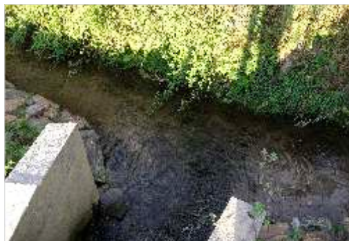
Výustní objekt do Olšanského potoka, denně zde vytéká přes 1 mil. litrů vyčištěné vody.
