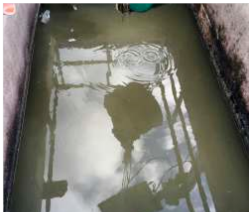
Pohled na splaškovou vodu přitékající do čistírny.
